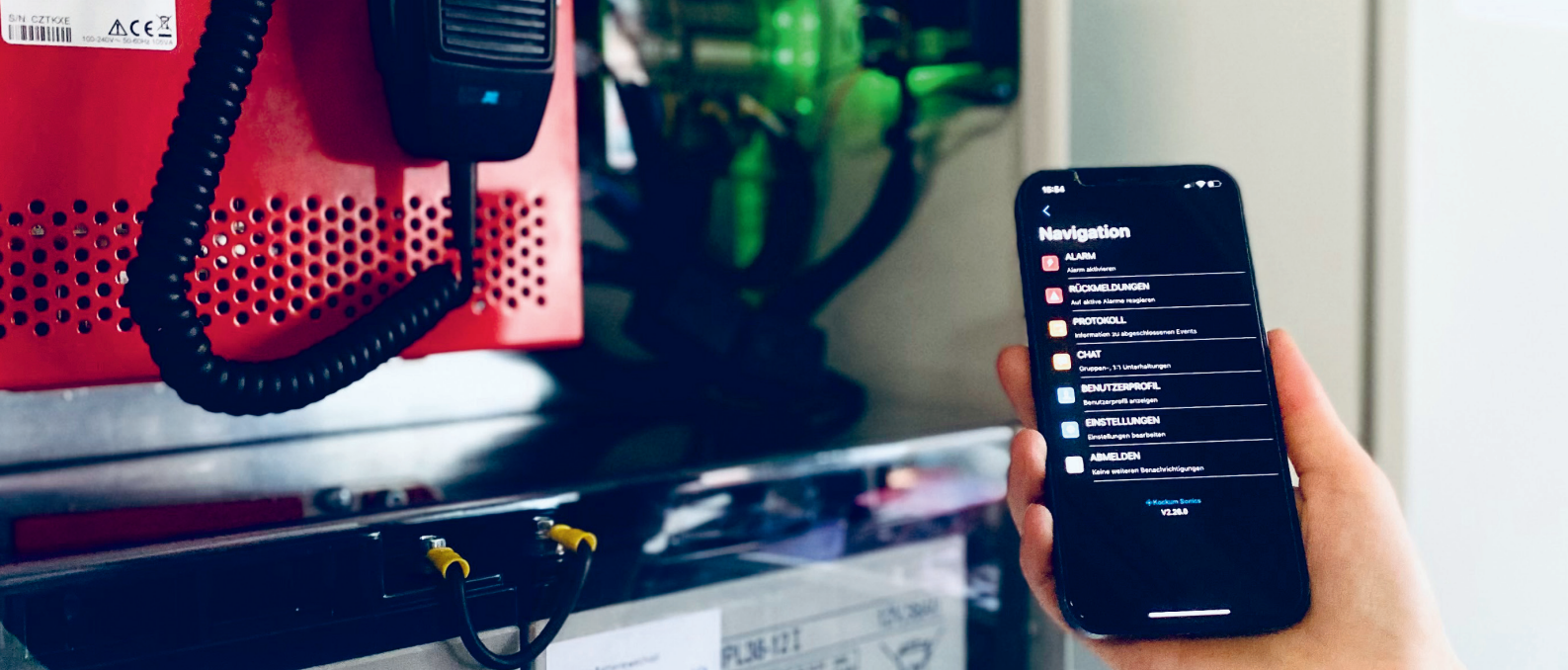
Installazione HW nella centralina
